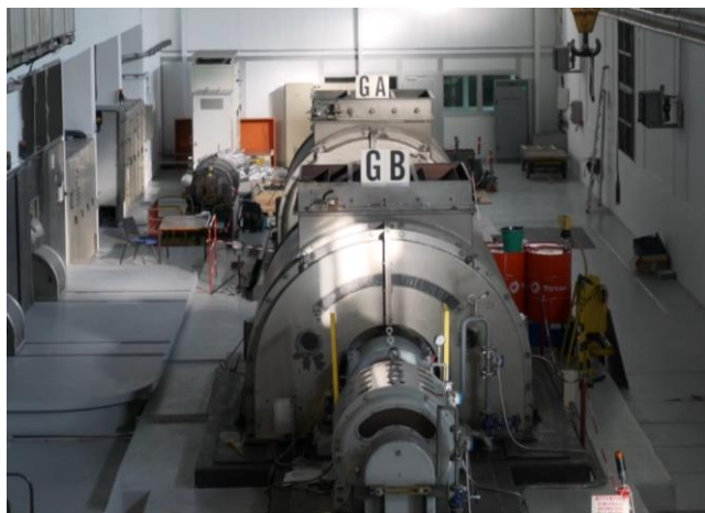
Figure 4 : un des alternateurs de test de la plateforme FC-Lab de Schneider
