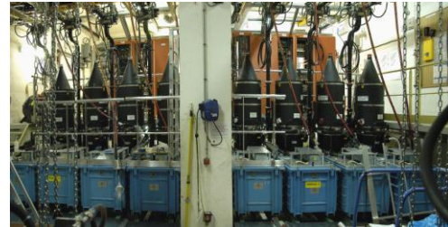
Figure 8 : Ensemble des Klystrons et des leurs interrupteurs associés
