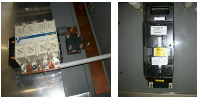
Fig.8 Dispositifs de sécurité consistant en une diode de protection, un contacteur électromécanique (photo gauche) et un fusible de fort courant (photo droite). Ces dispositifs de sécurité sont établis pour chaque colonne.
