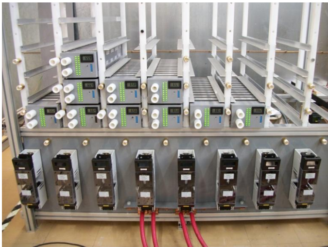
Fig.7 Photo de la batterie avec les modules à 20 cellules intégrés dans une armoire à étagères. En bas, on peut voir les fusibles pour chaque colonne et la sortie commune avec des câbles de fort courant (en rouge).
