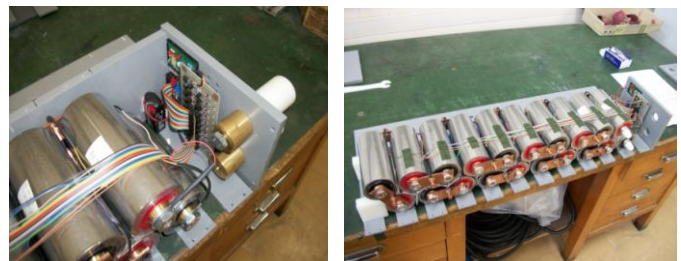
Fig.10 Module à 20 cellules LFP avec une surveillance électronique de tension de chaque cellule.
